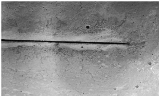
图 1 灌菌前裂缝状况
