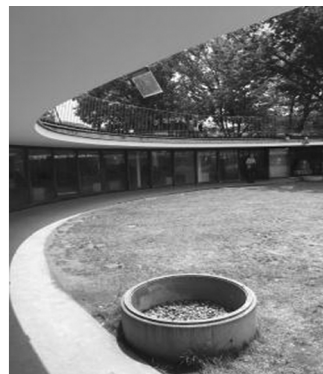
图8 屋顶雨水排水设施展示
