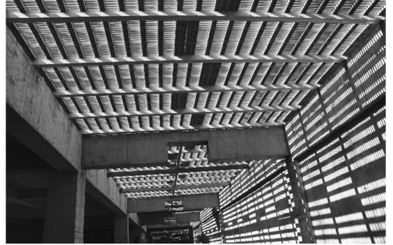
图 6 养殖区域漏缝地板
