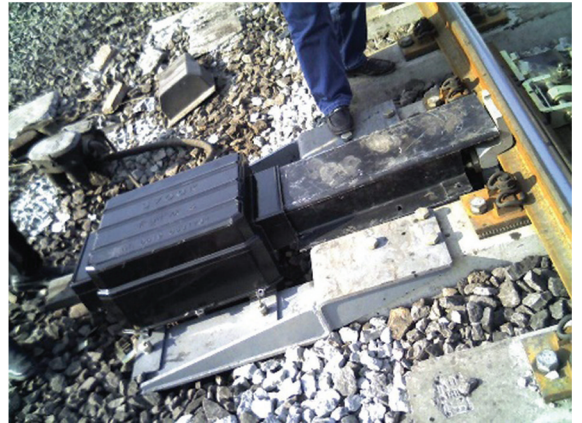
图 7 道岔转辙机防护罩的限位
