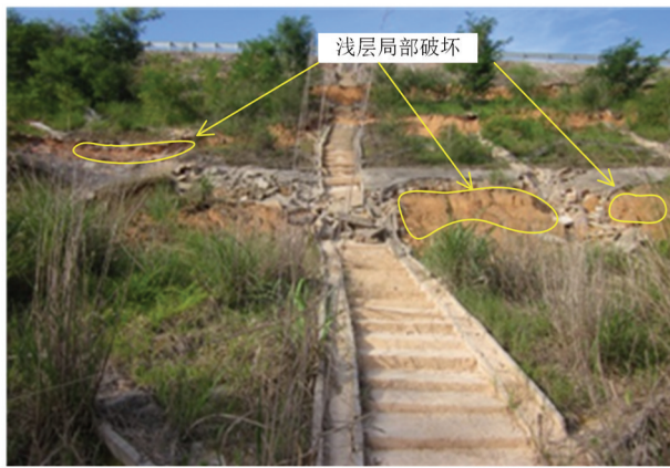
图 5 宁武高速某边坡浅层破坏
