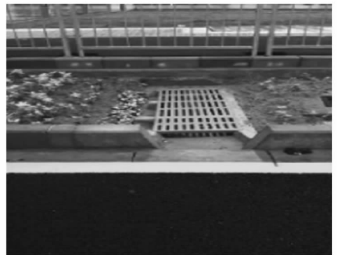
图 12 生物滞留设施孔口道牙、沉砂池
