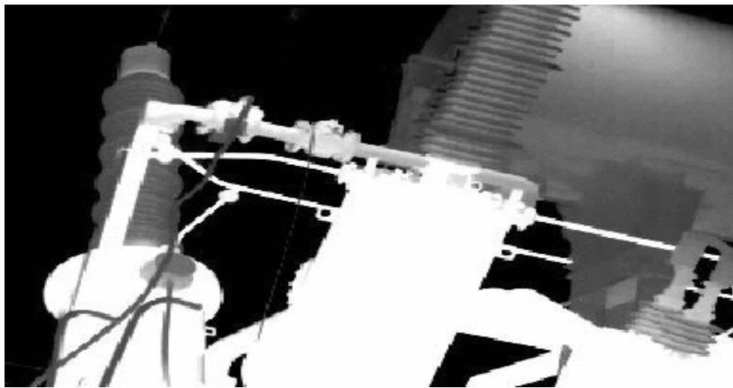
图1 220 kV 某变压器油枕热成像测试图
